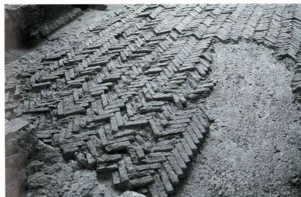
Fig. 4 - Varignano Vecchio (Sp). Pars fructuaria. Consolidamento in situ del pavimento in opus spicatum del torcularium .
